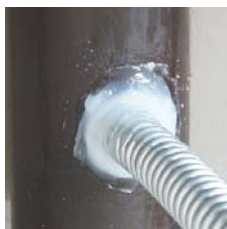
雨水管に挿し込んでスキマをコーキング処理している
