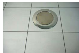
床面に設置された掃除口
