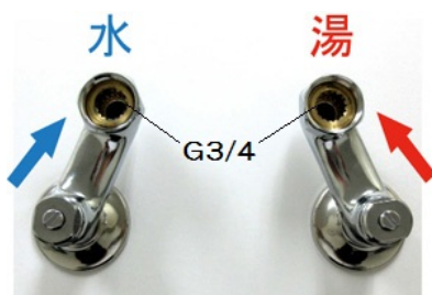
湯・水が逆配管になっている
